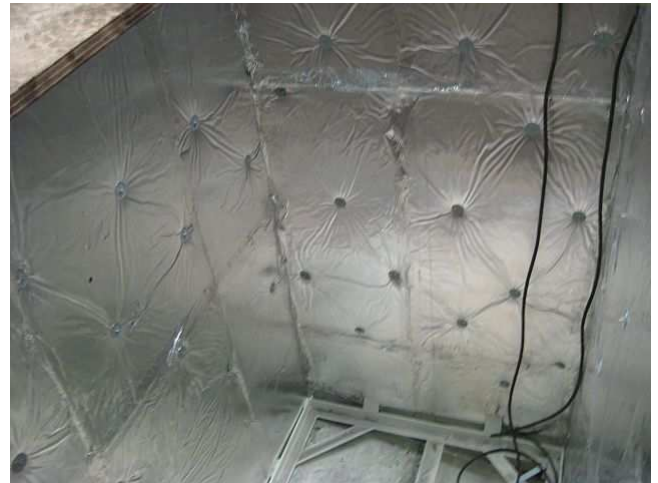
De geïsoleerde ruimte waar de gastanks binnenkort ingetakeld worden.
